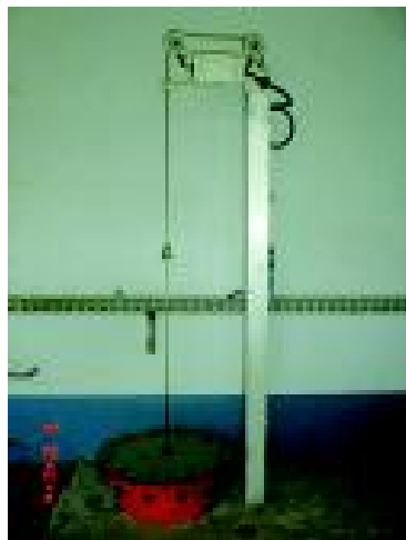
Figura 3-10. Sistema de flotador en campana de vacío de decantador pulsante (6)
