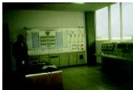
Figura 3-27. Sala de operación de una planta de patente importada (5)
