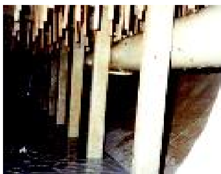
Figura 2-89. Instalación de lavado defectuosa (1)
