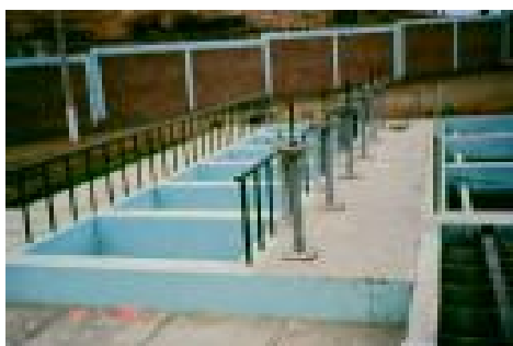
Figura 2-83. Batería de filtros de tasa declinante y lavado mutuo de pequeña capacidad
