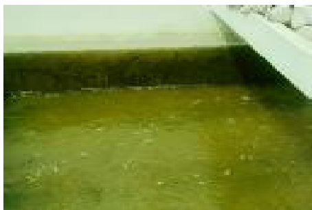
Figura 2-77. Lecho filtrado colmatado por algas (1)
