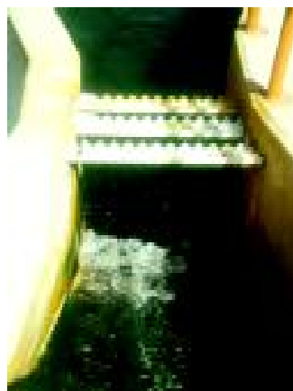
Figura 2-6. Canaleta Parshall en operación (1)
