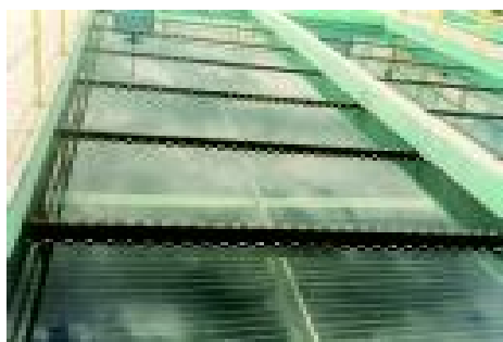
Figura 2-53. Módulo de decantación de placas paralelas (1)
