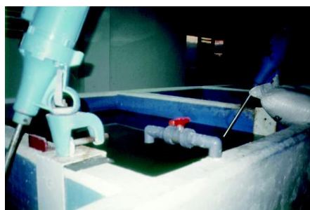
Figura 2-24. Tanque de preparación de la solución (1)
