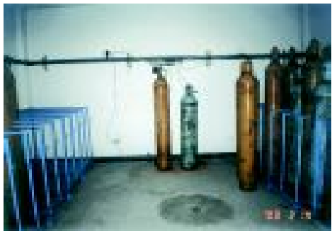
Figura 3-132. Sala de cloración incompleta (1)
