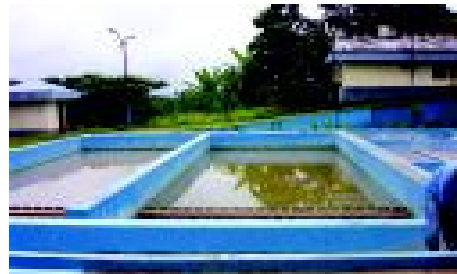
Figura A-9. Decantadores convencionales
