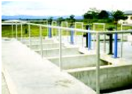
Figura 3-77. Batería de filtros con interconexiones mediante canales (1)
