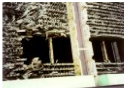
Figura 3-66. Módulos de plástico deteriorados (2)
