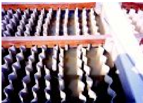
Figura 3-20. Floculador con un mal sistema de sujeción (1)
