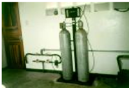
Figura 3-129. Sala de cloración con ventilación defectuosa
