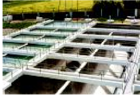
Figura 3-58. Decantadores del tipo vuelta en U (2)
