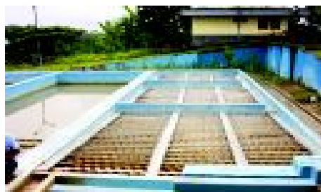
Figura A-8. Floculador hidráulico de flujo horizontal
