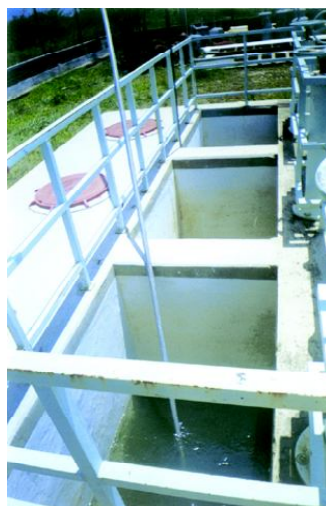
Figura 3-74. Batería de tres filtros (1)
