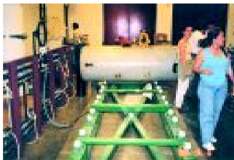
Figura 3-110. Sala de cloración con ventilación forzada (1)
