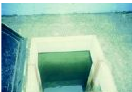
Figura 3-76. Vertedero de salida común a toda la batería (1)
