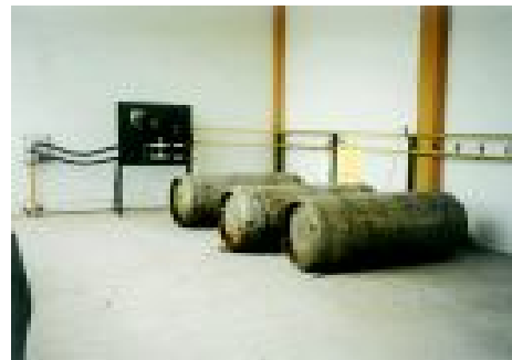
Figura 3-124. Sistema incompleto, operación riesgosa (1)
