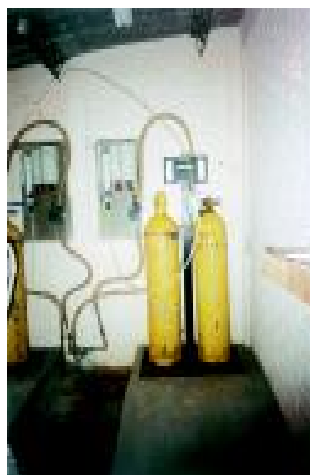
Figura 3-131. No tiene ventilación adecuada (1)
