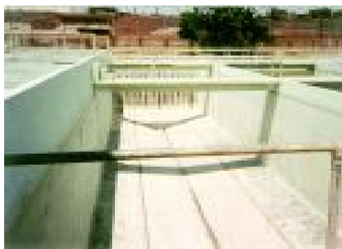
Figura 3-61. Estructura de entrada del decantador (2)
