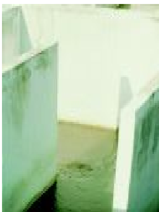
Figura 3-22. Floculador de pantallas de flujo horizontal (1)
