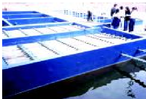
Figura 3-33. Primer tramo del floculador sin pantallas (1)
