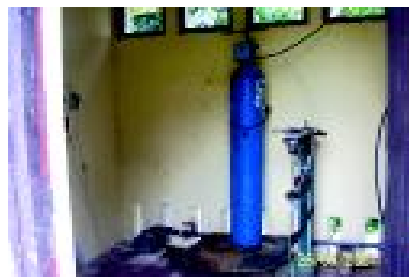
Figura A-11. Caseta de cloración
