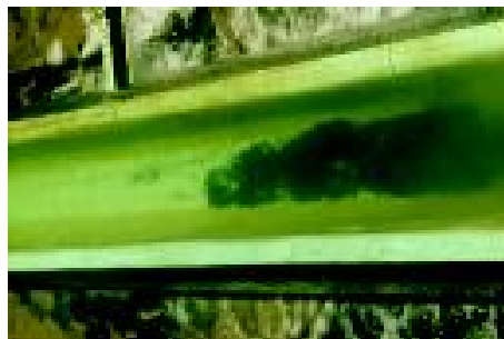
Figura 3-96. Arena en las canaletas de lavado (1)
