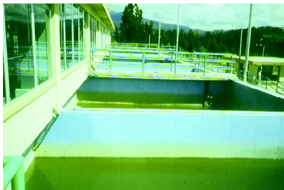
Figura 3-100. Vista de la batería de filtros evaluada (1)
