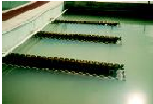
Figura 3-50. Estructura de salida de un decantador convencional (2)
