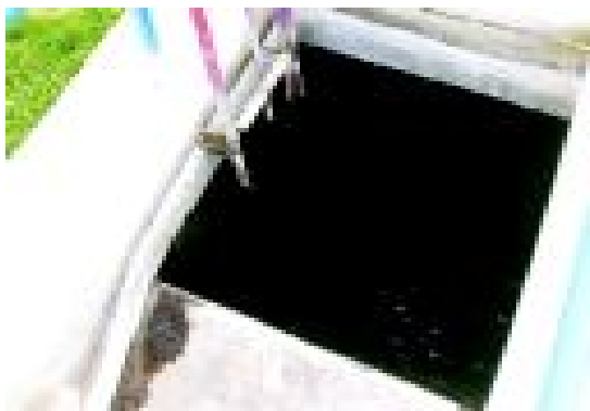
Figura 3-17. Caja de entrada de la unidad tipo rampa (1)
