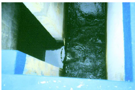
Figura 3-75. Vertedero individual en cada filtro (1)
