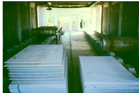
Figura 3-116. Almacén de cilindros de cloro (1)
