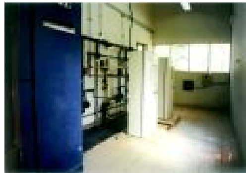
Figura 3-112. Sala de cloración con ventilación forzada (1)
