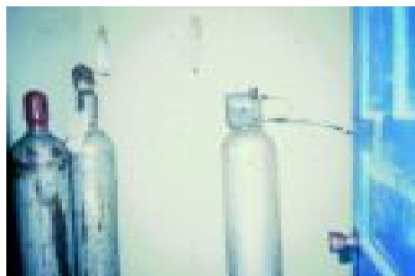
Figura 3-127. Sala de cloración y almacén de planta pequeña (1)
