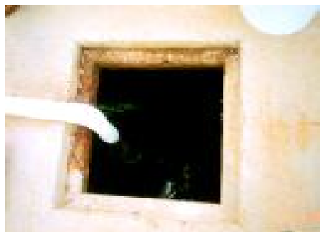
Figura 3-109. Aplicación incorrecta de cloro (1)
