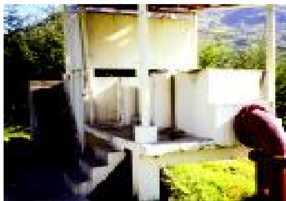
Figura 3-15. Ubicación de la canaleta Parshall de la figura 3-13 (1)
