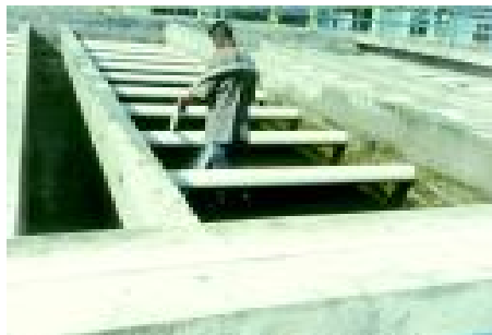
Figura 3-68. Operador parado sobre las pantallas de asbesto-cemento (2)
