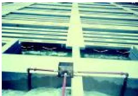
Figura 3-23. Floculador de pantallas de flujo horizontal (1)
