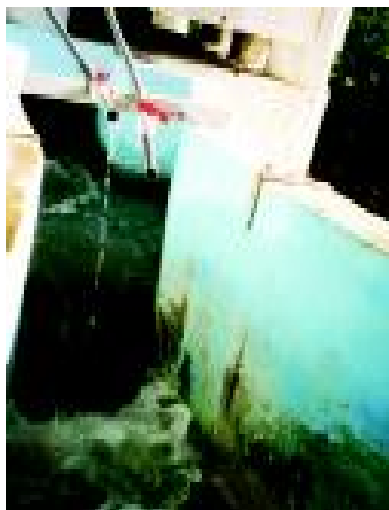
Figura 3-14. Canaleta Parshall como medidor y mezclador (1)
