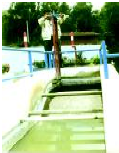
Figura 3-16. Mezclador tipo rampa en la entrada al floculador (1)
