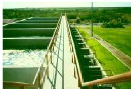
Figura 3-78. Batería de filtros con interconexiones mediante tuberías (1)
