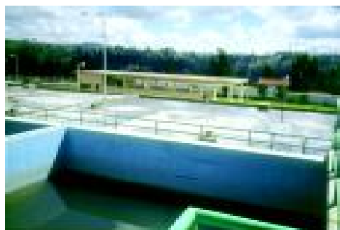
Figura 3-121. Caseta de cloración y almacén de cloro (1)
