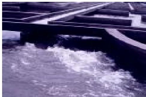
Figura 3-21. Floculador de pantallas de flujo horizontal (1)
