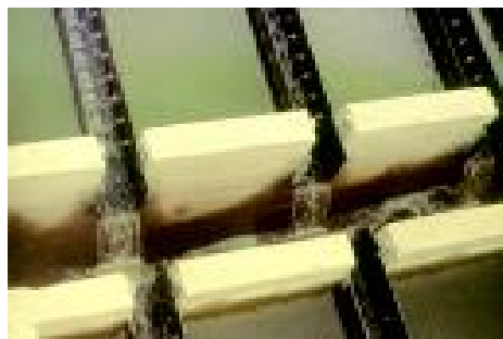
Figura 3-72. Sistema de recolección mediante canaletas (2)
