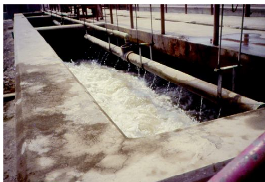
Figura 3-10. Mezclador hidráulico operando correctamente (1)
