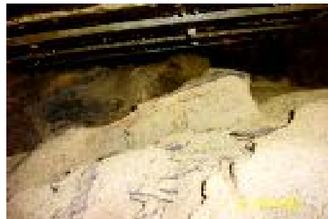
Figura 3-97. Arena en el falso fondo del filtro (1)
