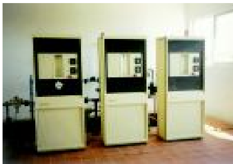
Figura 3-115. Sala de cloración sin ventilación a la altura del piso (1)
