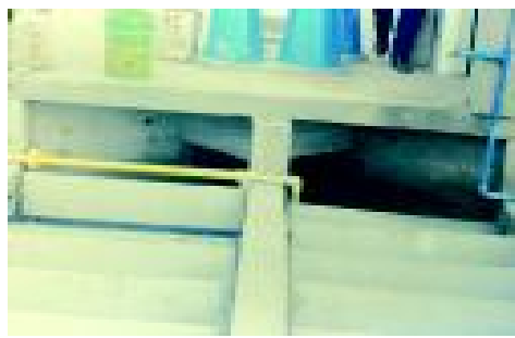
Figura 3-27. Sistema de sujeción defectuoso (1)
