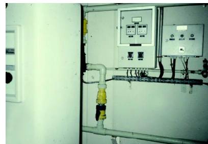
Figura 6-34. Sistemas de protección (2)
