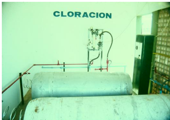
Figura 6-42. Sala de cloración defectuosa (2)
