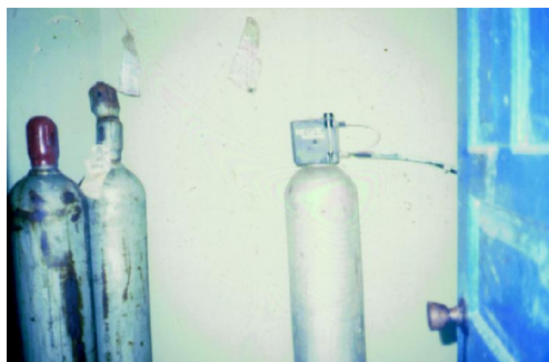
Figura 6-43. Sala de cloración mal instalada (2)
