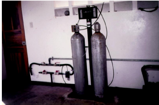
Figura 6-44. Sala de cloración mal ventilada (2)
