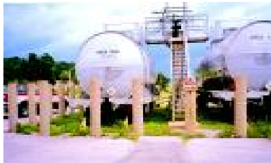
Figura 6-1. Contenedores de cloro expuestos al Sol (2)
