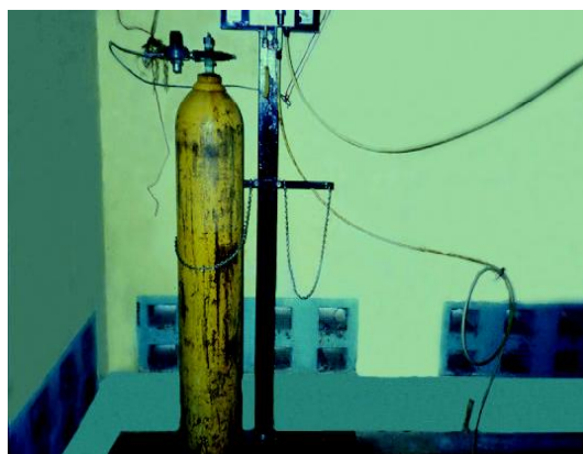
Figura 6-17. Clorador de aplicación directa a una tubería (2)
