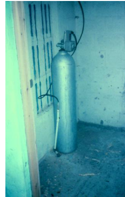
Figura 6-45. Sala de cloración incompleta (2)
