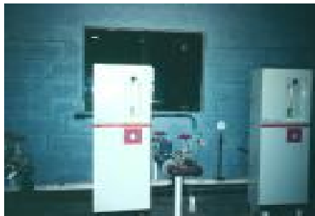
Figura 6-26. Cloradores de consola (2)
