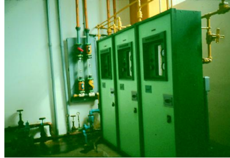
Figura 6-24. Cloradores de consola (2)
