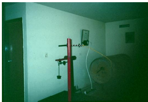
Figura 6-41. Sala de cloración mal ubicada e instalada (2)
