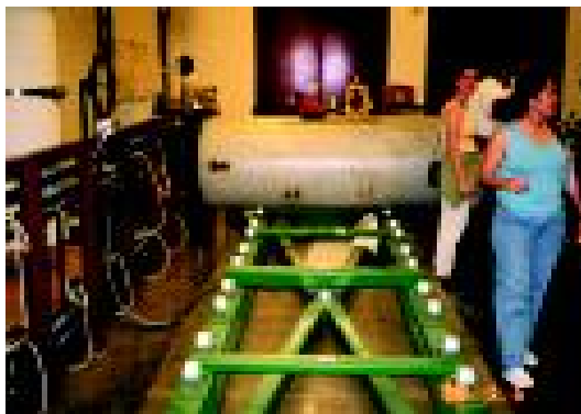
Figura 6-3. Almacén de cloro cerrado con ventilación artificial (2)
