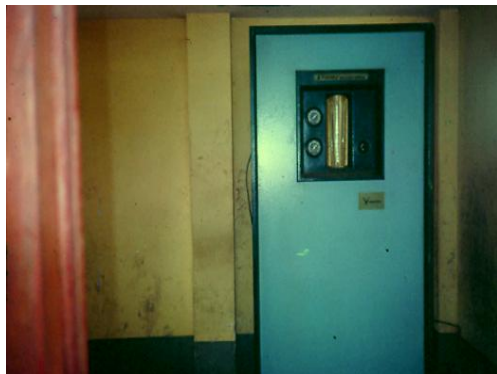
Figura 6-39. Falta un clorador alternativo (2)
