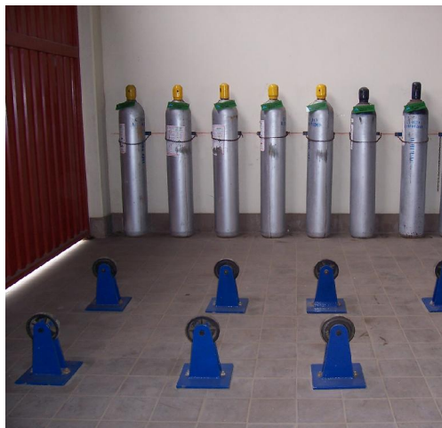
Figura 6-5. Almacén de cilindros pequeños (2)
