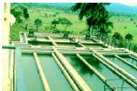
Figura 4-35. Sistema de recolección mal instalado (4)
