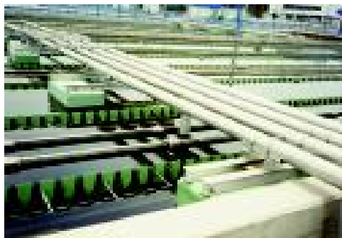
Figura 4-28. Sistema CLARIVAC de extracción de lodos
