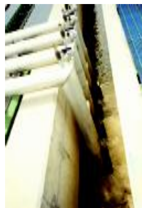
Figura 4-29. Canal de descarga del sistema CLARIVAC
