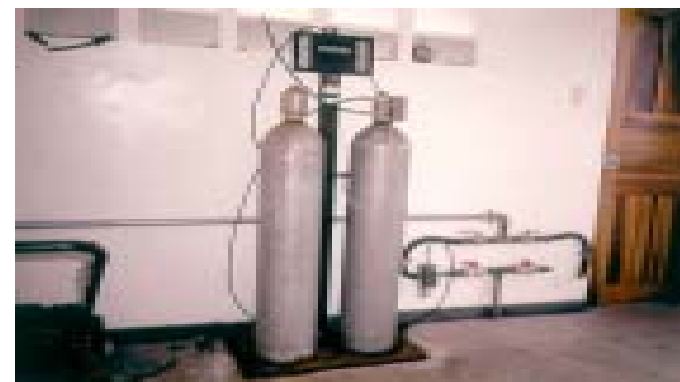
Dosificadores de gas de tipo directo
