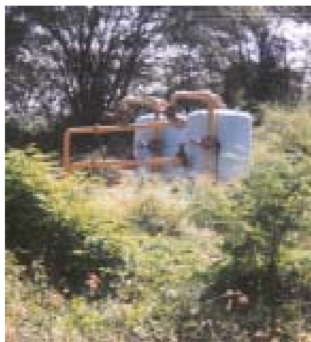
Batería de filtros a presión de flujo vertical
