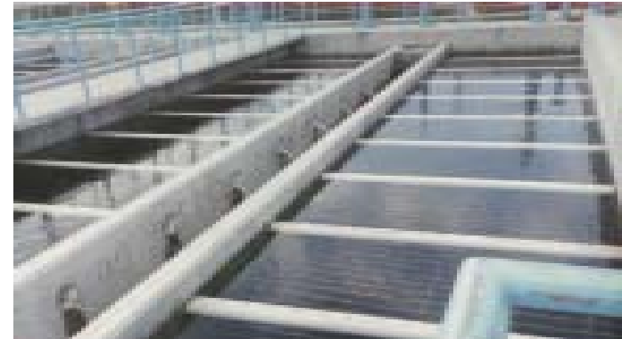
Decantador laminar de placas paralelas
