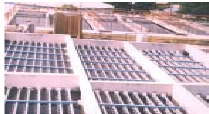
Floculador de pantallas de flujo horizontal
