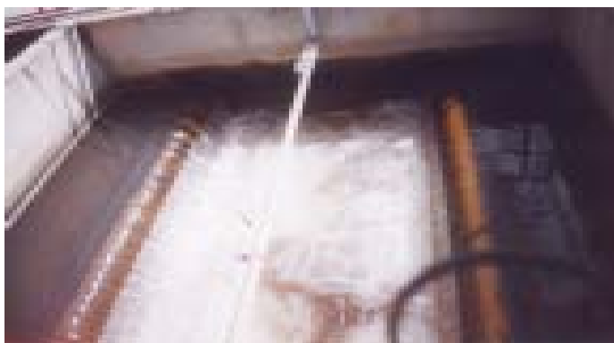
Aeradores de caída de gravedad de tipo cascadas múltiples
