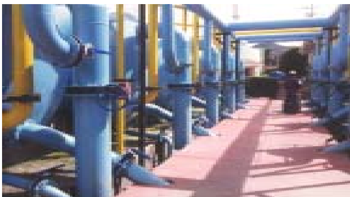
Batería de filtros a presión de flujo horizontal
