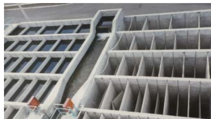
Floculadores de pantallas de flujo horizontal (fotografía superior) y vertical (inferior)
