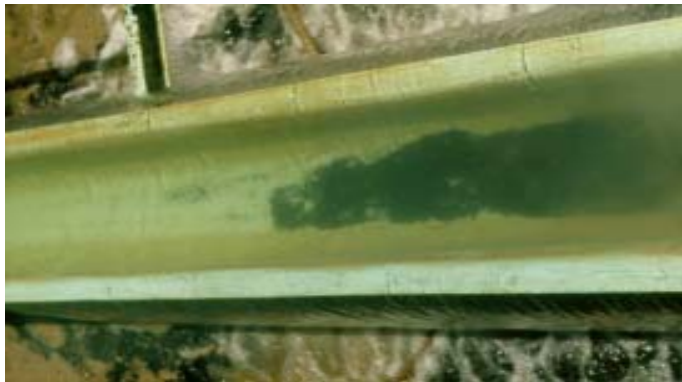
Pérdida de arena o antracita durante el lavado
